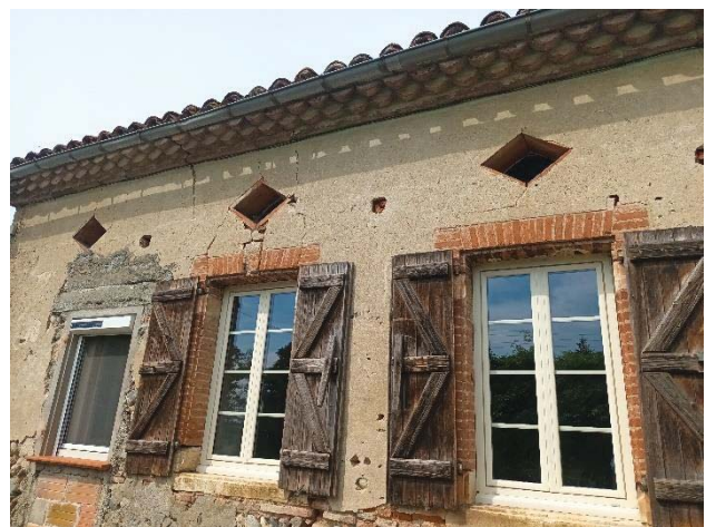
Figure 7 : Paroi d'un bâtiment avec volets et fissures potentiellement favorables © Mathilde Cassé
