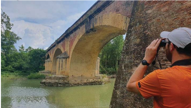
Figure 8 : vue sous le pont de Carbonne avec des fissures potentielles © Mathilde Cassé
